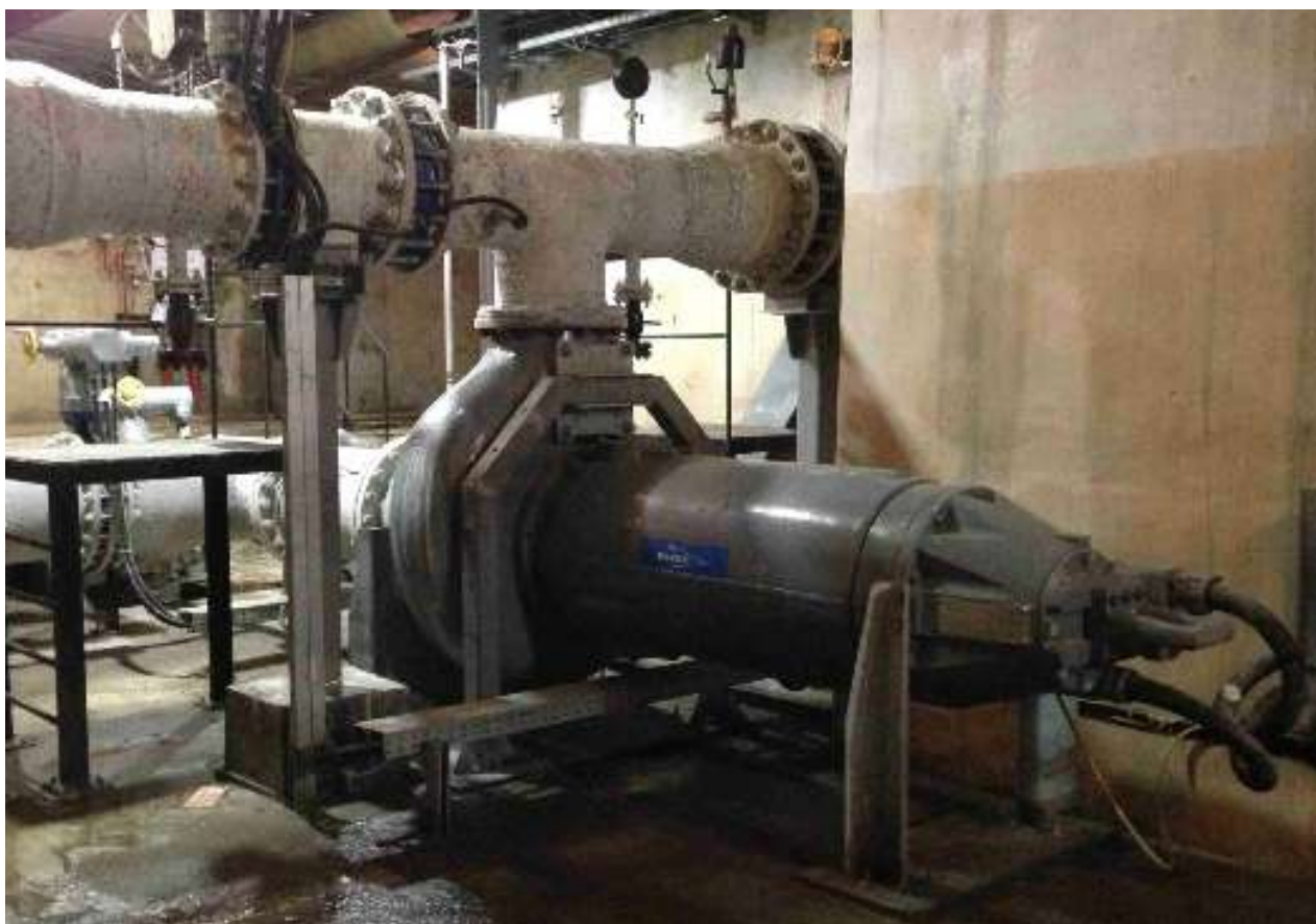
Насосное оборудование: 3 насоса FLYGT CZ 3400/882, ( Q=750 \text{ м}^3/\text{ч} , H=35 \text{ м} , N=305 \text{ кВт} ).
