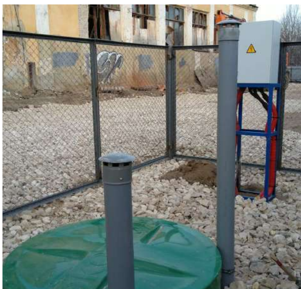
Поставка и пусконаладка комплектной КНС производительностью 100м 3 /ч «Первый этап строительства ОЭЗ ППТ "Липецк", Елецкий район Липецкой обл. (подэтап 1.3)»
