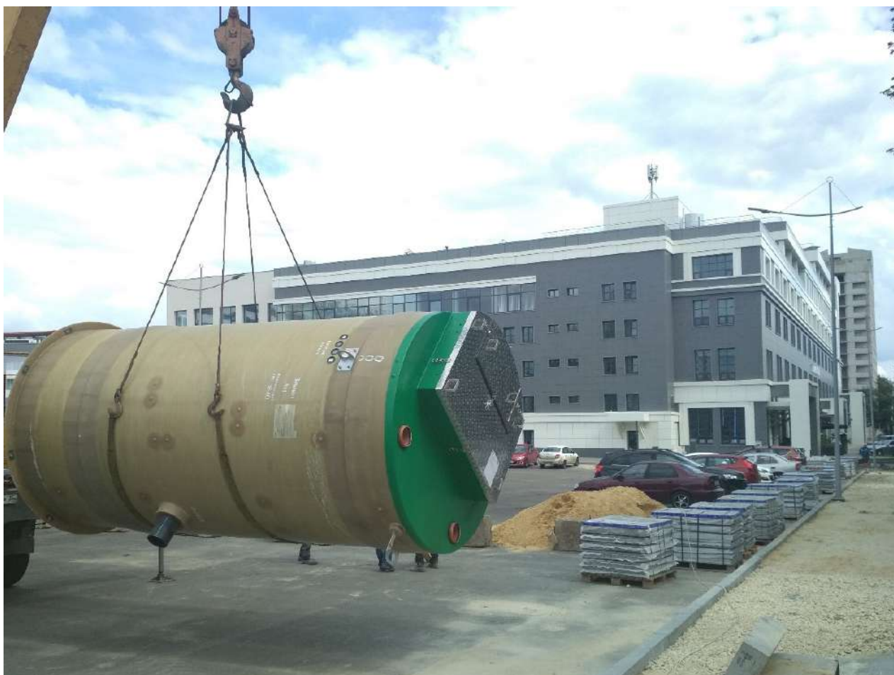
Поставка комплектной КНС производительностью 248м 3 /ч Бизнес-центр в г.Воронеж
