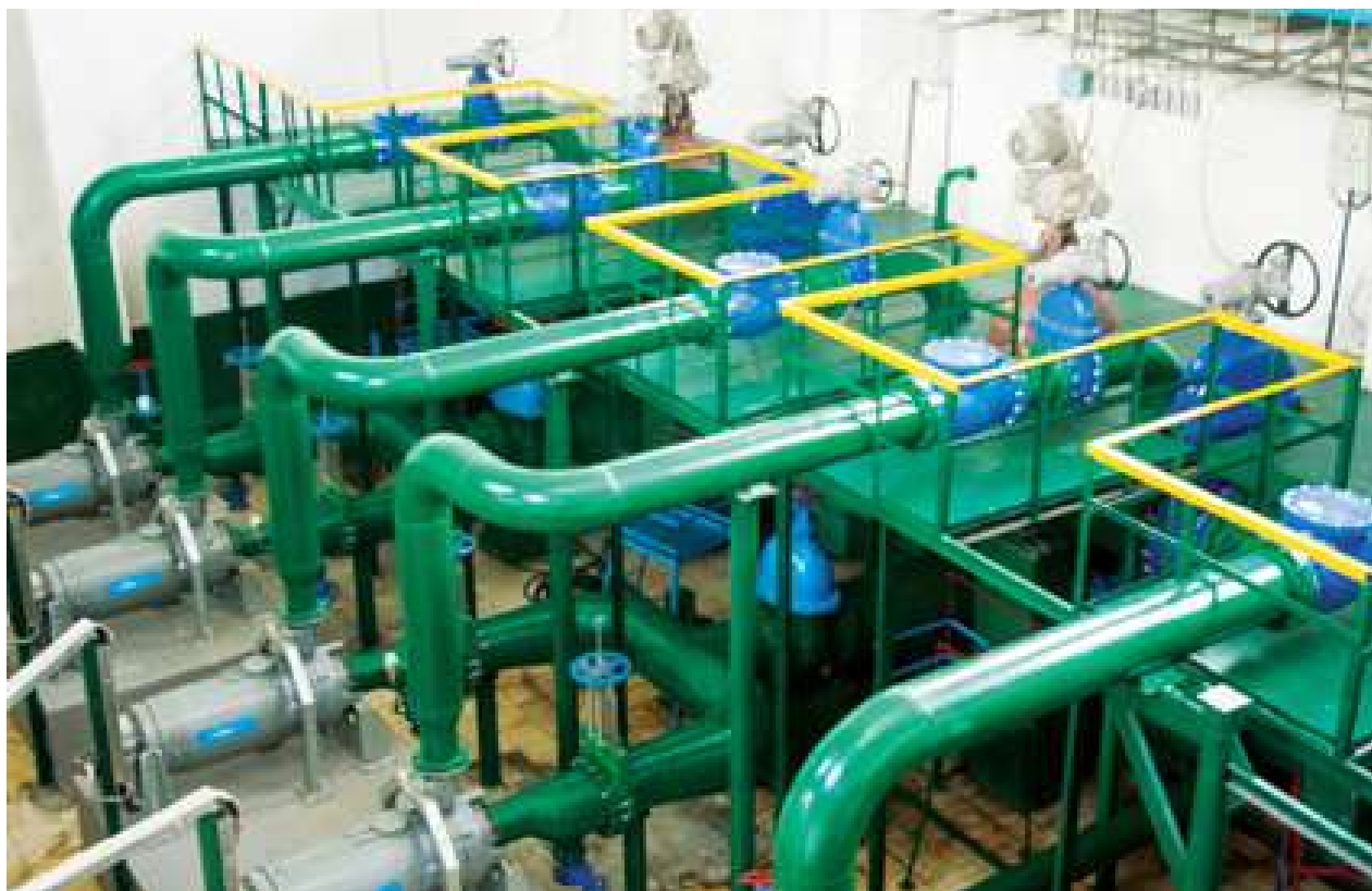
Насосное оборудование: 4 насоса FLYGT NZ 3231/735, ( Q=156,2 л/с, H=59,2 м, N=170 кВт).
