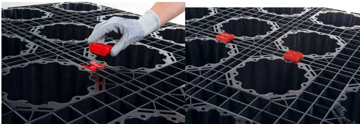
Рис. 16. Установка двойных коннекторов
