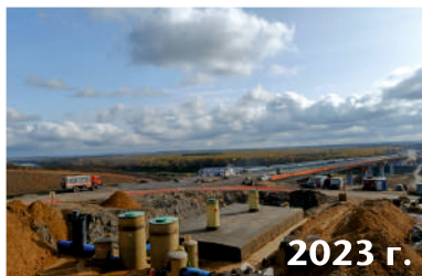
2023 г. 6 этап М-12 «Восток», Нижегородская обл. Регулирующий резервуар перед ЛНС
