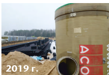
2019 г. Индустриальный парк «Великий Камень», Республика Беларусь. Резервуар в составе ЛОС
