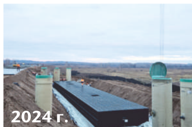
2024 г. Участок Дюртюли-Ачит М-12 «Восток», респ. Башкортостан. Каскад из 6 регулирующих резервуаров ЛНС
