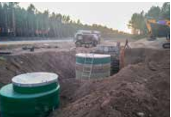
Космодром Восточный, Амурская обл. Комплекс КНС
