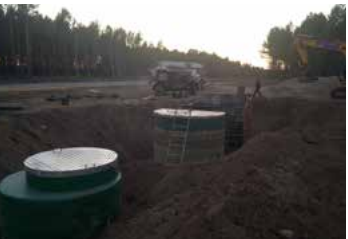
Космодром Восточный, Амурская обл. Комплекс КНС
