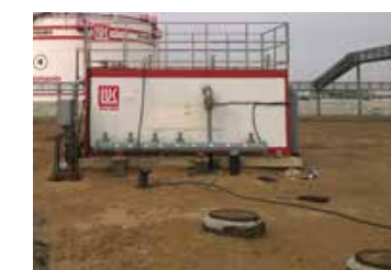
Объекты ПАО Лукойл, Респ. Калмыкия ЛОС поверхностного стока и КНС
