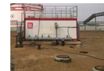
Объекты ПАО Лукойл, Респ. Калмыкия ЛОС поверхностного стока и КНС
