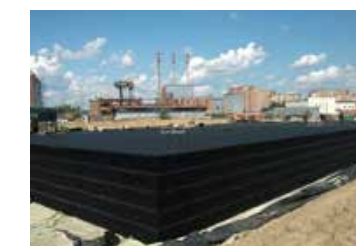
Транспортная развязка МКАД - М1 "Беларусь", Московская обл. ЛОС с резервуаром ACO StormBrixx
