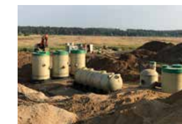
Центральная кольцевая автодорога "Беларусь", Московская обл. ЛОС и КНС для 5го пускового комплекса, Московская обл.
