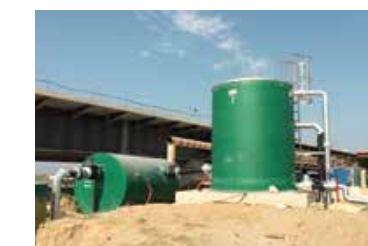
Керченский мост ЛОС в наземном исполнении с резервуарами ACO StormBrixx
