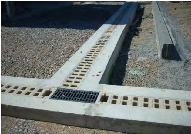
■ Каналы в бетонной обойме
